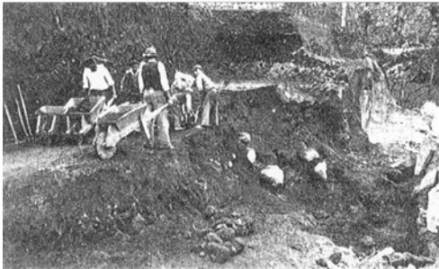
Fig. 53 Trabalhos de desaterro, mostrando a grande profundidade a que se encontrava o monumento (© Mário Cardozo)
