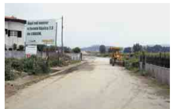
LANDIM Construção de acessos à futura Escola do 2º e 3º Ciclo
