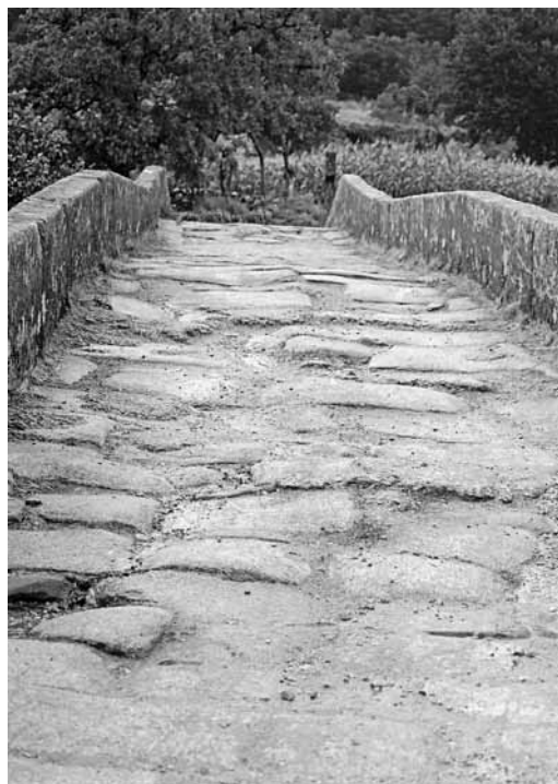
▲ Fig. 13 Pavimento de um tabuleiro de uma ponte românica, com corcova e guardas.
