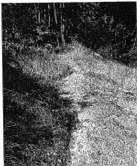
Acesso usado indevidamente por veículos
